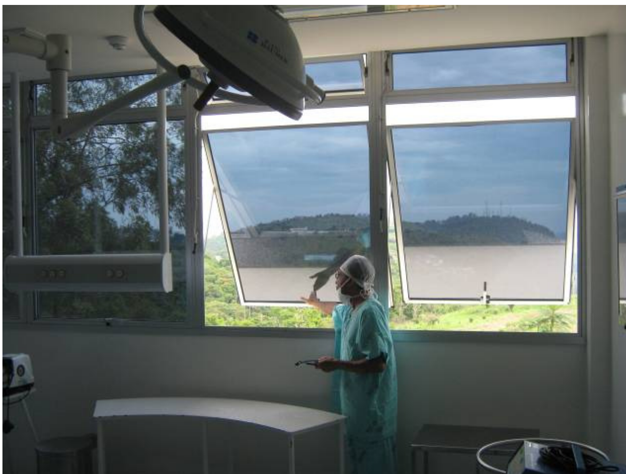
FOTO Nº. 02/12: FALHA GRAVE - JANELA COM ABERTURA EM SALA DE CIRURGIA.
